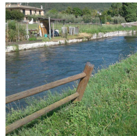
Le staccionate danneggiate della Gavardina a fianco del naviglio|Un altro tratto senza ripari|Il naviglio e i supporti mancanti
