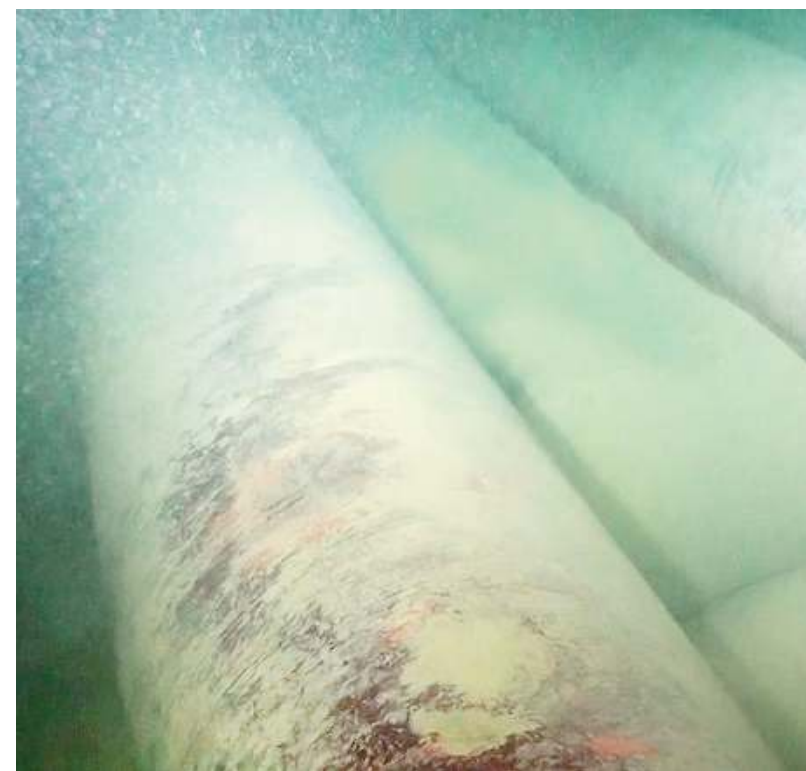
Punto critico. La condotta sublacuale nell'Alto Garda
